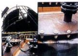
ケミカルタンク
